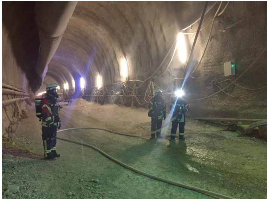
Ein Feuerwehrrupp steht in einer Tunnelröhre für die Brandbekämpfung bereit
